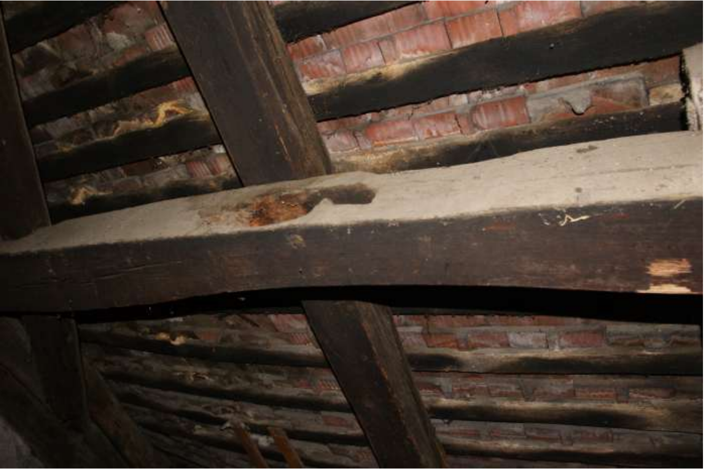
Figure 77. Entrait daté 1522 réemployé comme entretoise. Noter la dégradation autour de la mortaise, indiquant que le bâtiment primitif a connu une phase longue d'abandon
