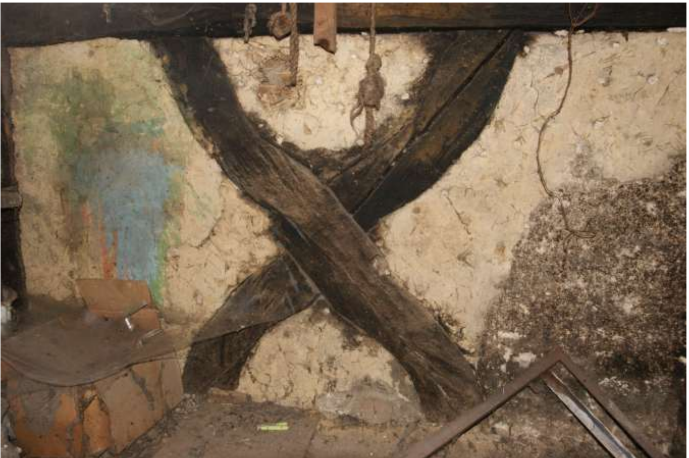
Figure 93. Croix en X à branches courbes du pignon Est, vu depuis l'intérieur (combles)
