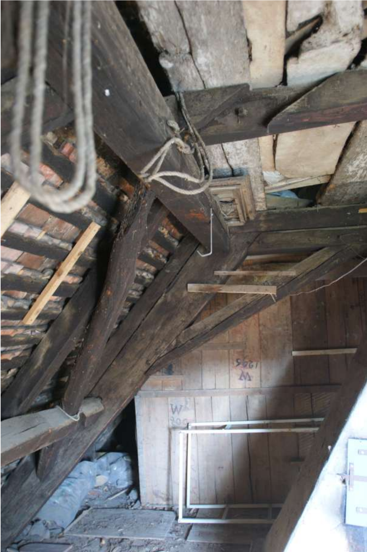
Figure 81. Versant nord. Solive réemployant une poutre avec entaille à mi-bois et queue d'aronde
