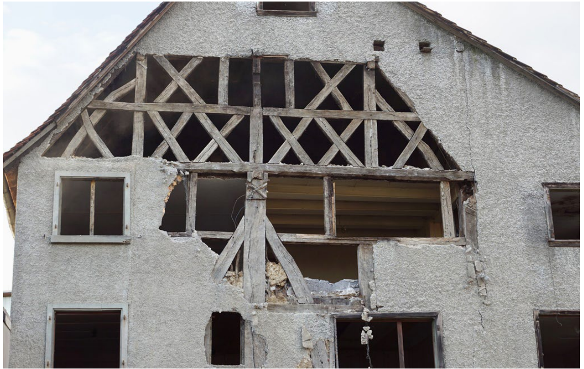
FIG. 8 : Buschwiller, 16 rue de Wentzwiller. Registres de croix de Saint-André sur le pignon côté rue en cours de dé-gagement des enduits.
