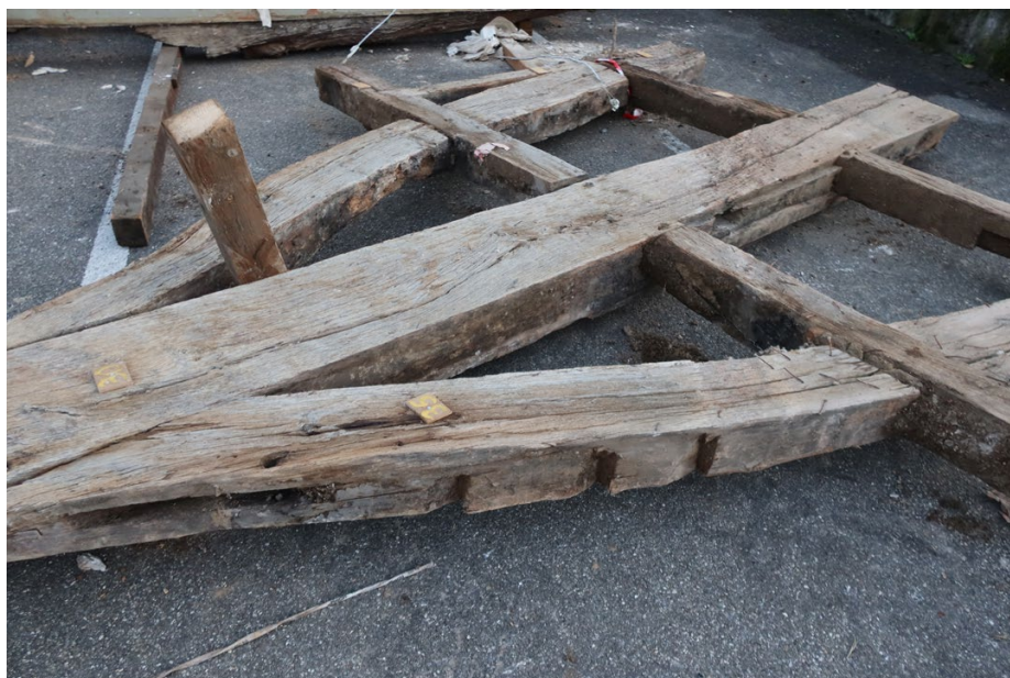
FIG. 23 : Buschwiller, 16 rue de Wentzwiller. Sur cette contrefiche du pignon sur rue apparaissent des encoches, peut-être crans de débitage intentionnellement conservés pour le logement des palançons du torchis.
