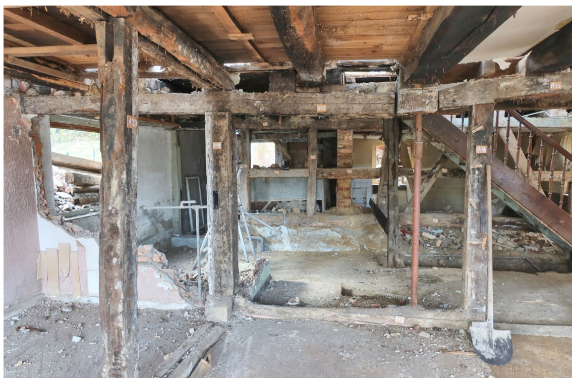
FIG. 13 : Buschwiller, 16 rue de Wentzwiller. Vue de la travée avant vers la travée centrale (voir coupe 4a). À gauche, sablière et solive rainurées de la cloison de planches séparant Stube et Kammer .
